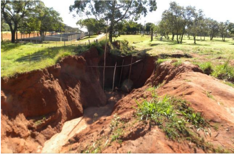
Figura 4 - Ravina formada em decorrência do escoamento superficial concentrado proveniente de área urbana.
