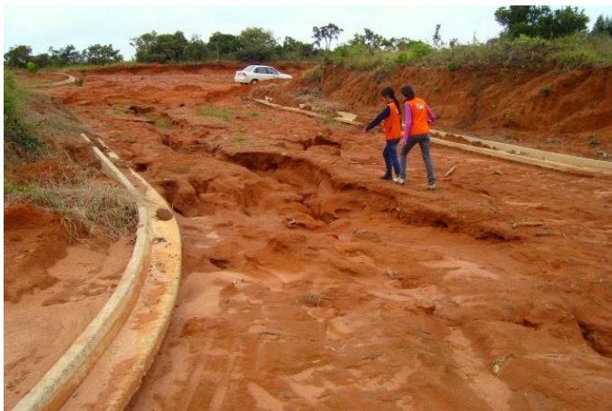
Figura 1 - Processo erosivo do tipo sulco em desenvolvimento em sistema viário de loteamento em fase de implantação.
