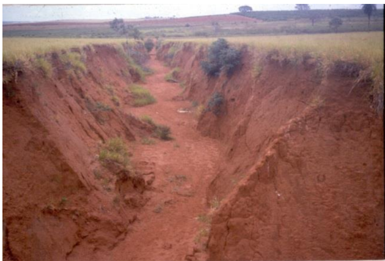
Figura 3 - Ravina formada pelo escoamento concentrado de águas pluviais provenientes de estrada vicinal.
